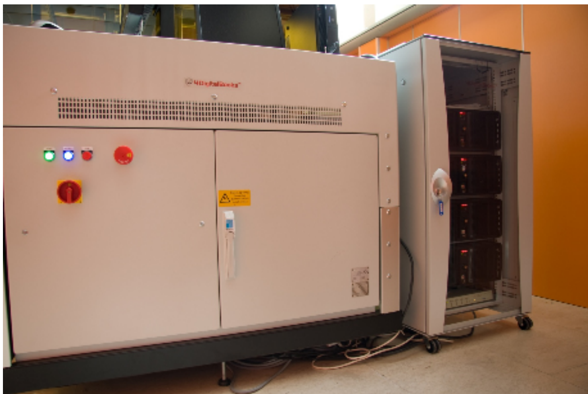
Obr.9 pripojenie do elektrickej siete
