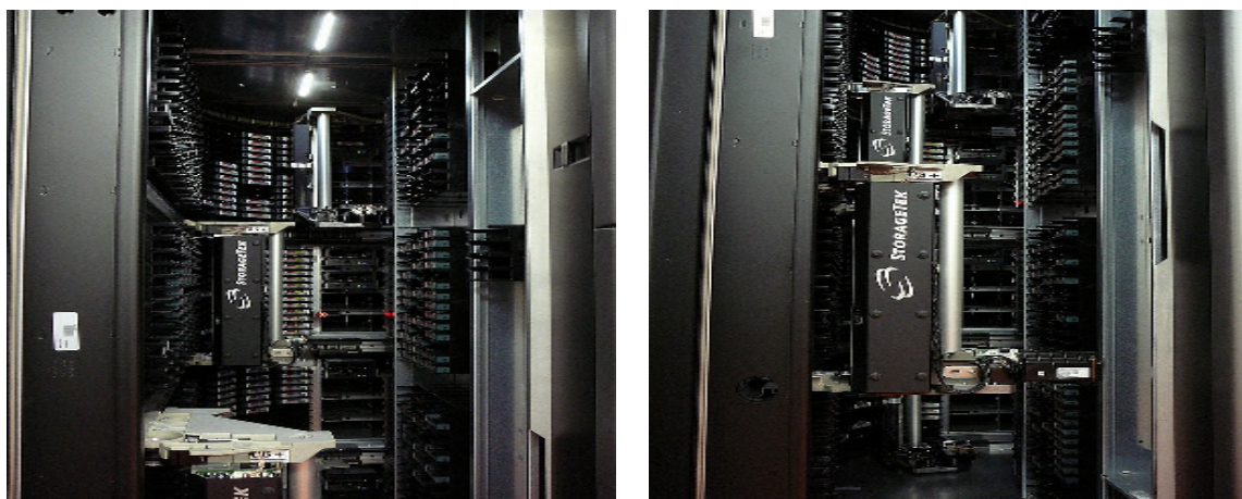
Obr.12 Vnútro dátového úložiska
